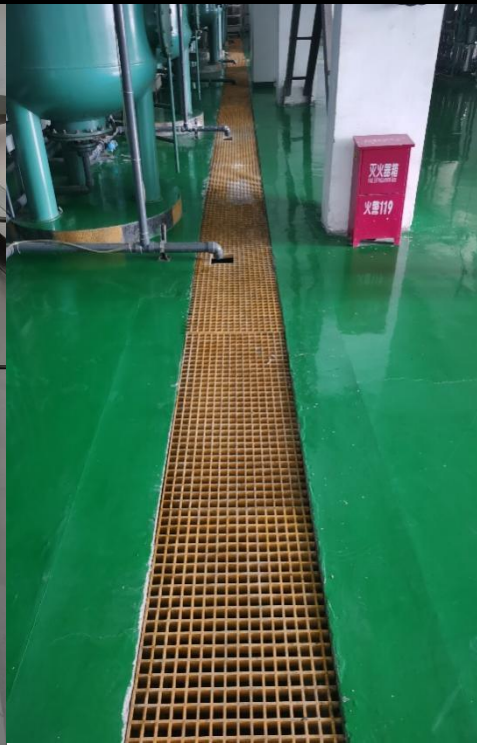
车间内部集液槽
